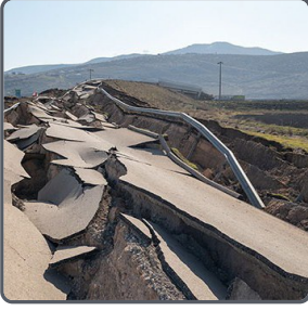
Görsel 1.35 · Depremde zarar gören yol
